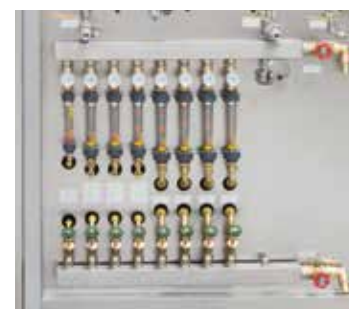
Rozdzielanie wody chłodzącej
